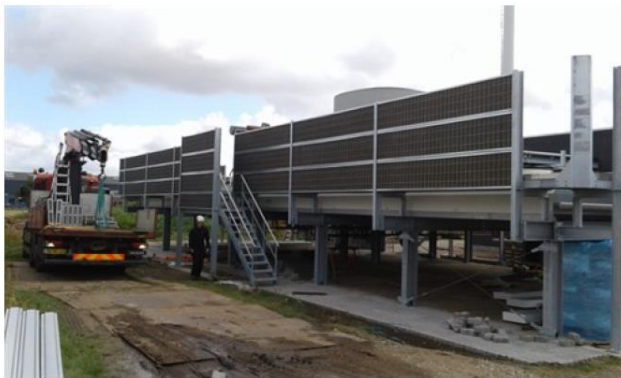
Figur 8.4 – Billede af støjskærm ved udeluftkølerne.
